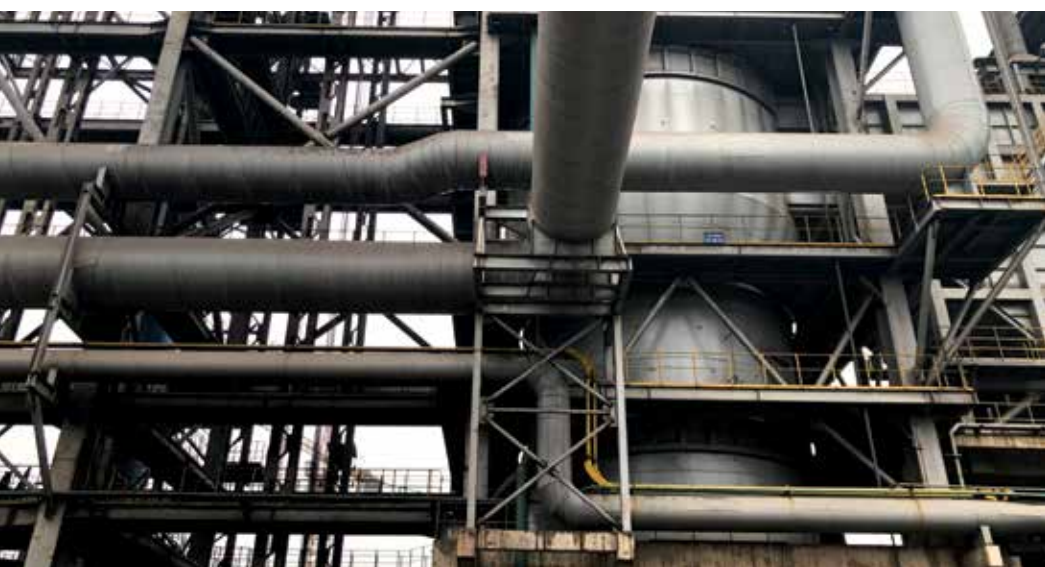
Lò CDQ làm nguội và thu nhiệt từ than cốc cấp nhiệt làm quay tuabin hơi - Công ty CP Năng lượng Hòa Phát.
