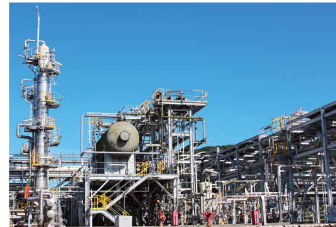
Nhà máy xử lý khí Nam Côn Sơn.
