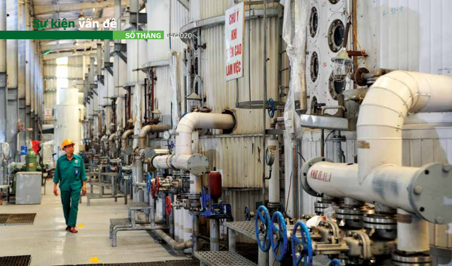
Nồi hơi trong nhà máy đường
