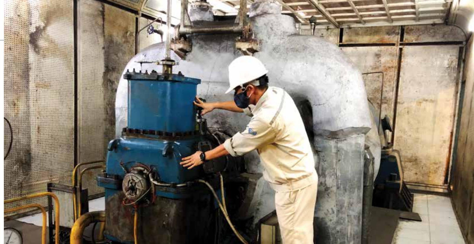
Kỹ thuật viên Công ty Thép Hòa Phát vận hành tuabin hơi và máy phát điện.
