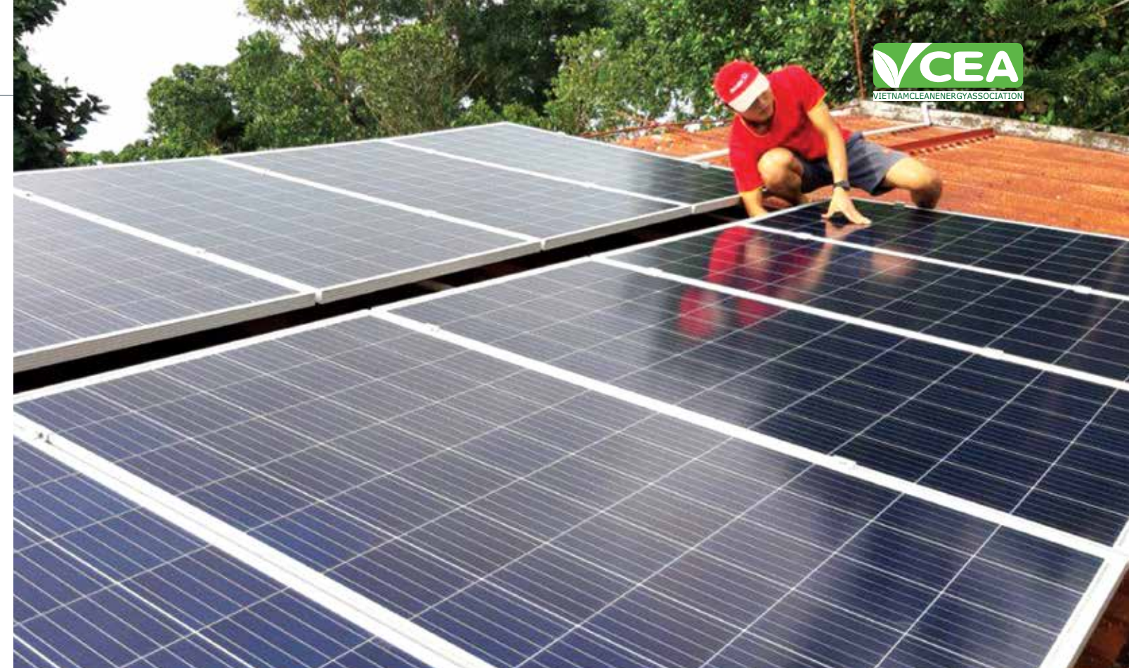
Điện mặt trời cung cấp điện cho cán bộ, chiến sĩ tại trạm Radar 610
