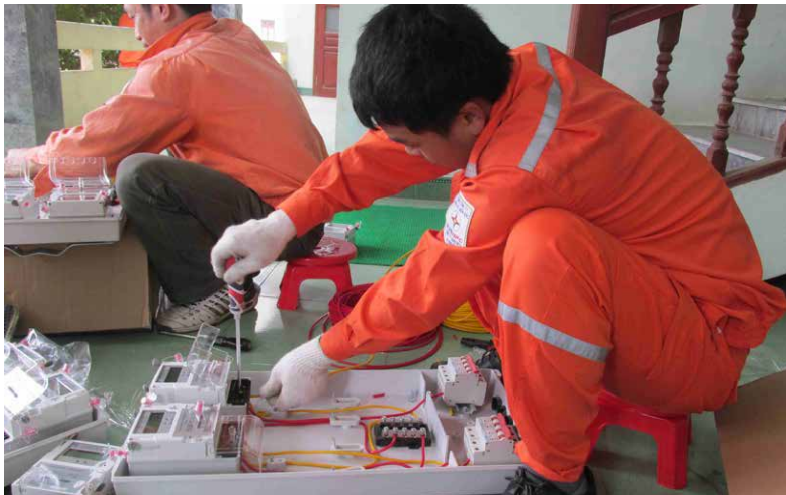
Ngành điện Ninh Bình tích cực ứng dụng khoa học công nghệ vào việc nâng cao độ tin cậy, an toàn của hệ thống điện.
