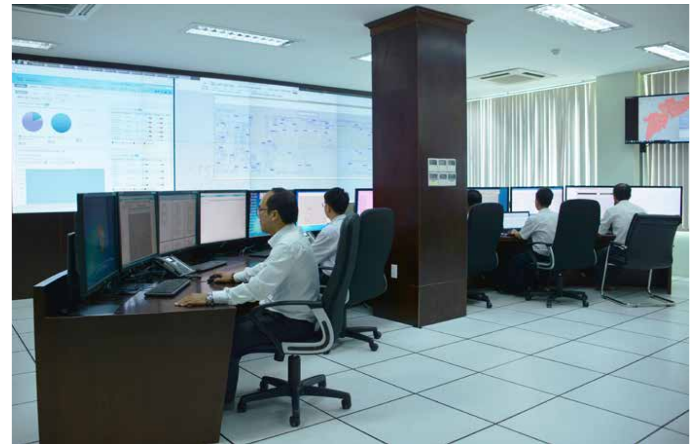
Hệ thống SCADA giúp quản lý lưới điện từ xa.
