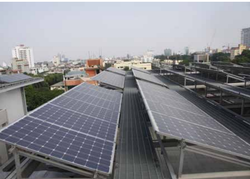
Hệ thống pin năng lượng mặt trời trên mái của tòa nhà LHQ.
