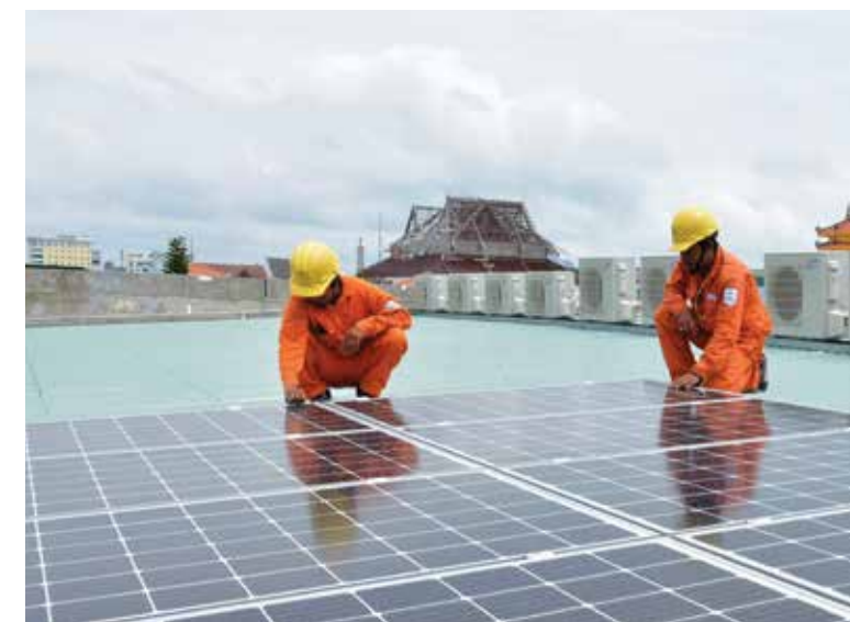
Dự án điện mặt trời áp mái đặt tại trụ sở Sở Công Thương tỉnh An Giang
