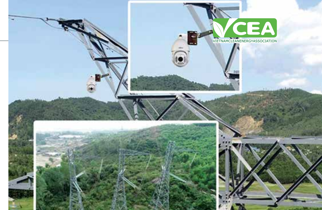
Hệ thống camera giám sát đường dây truyền tải điện.
