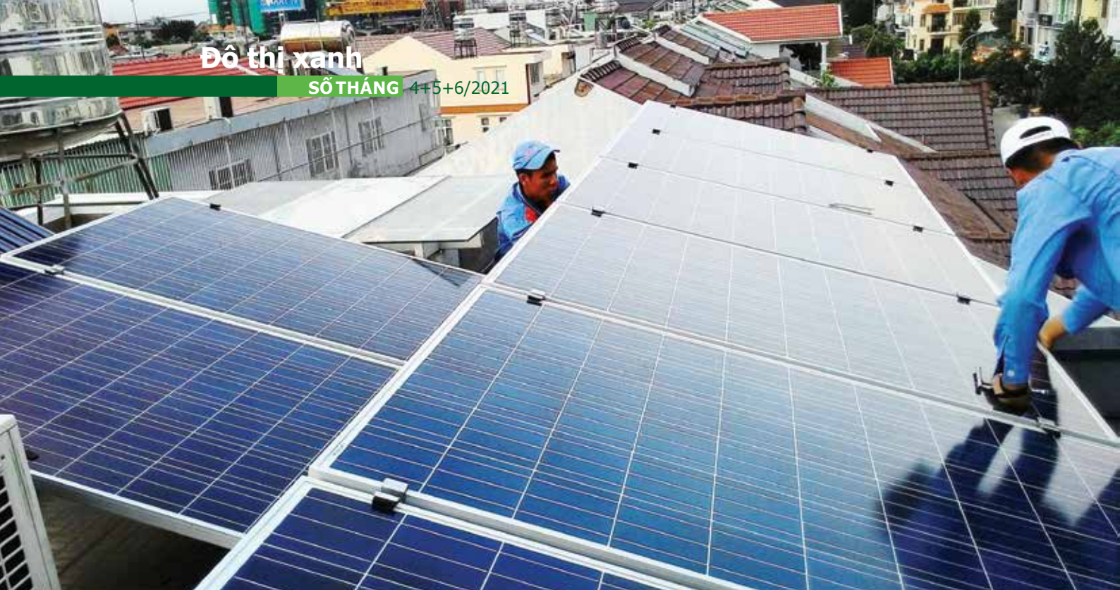
TP Đà Nẵng thúc đẩy phát triển điện mặt trời để phục vụ nhu cầu tự dùng và cung cấp cho hệ thống điện quốc gia.
