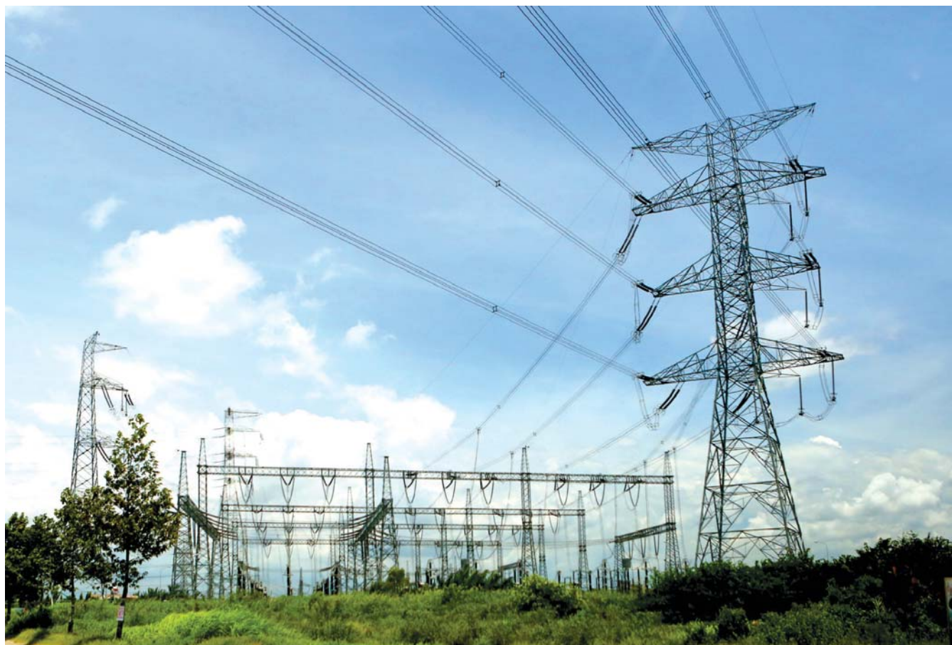
Trạm 500kV Nhà Bè
