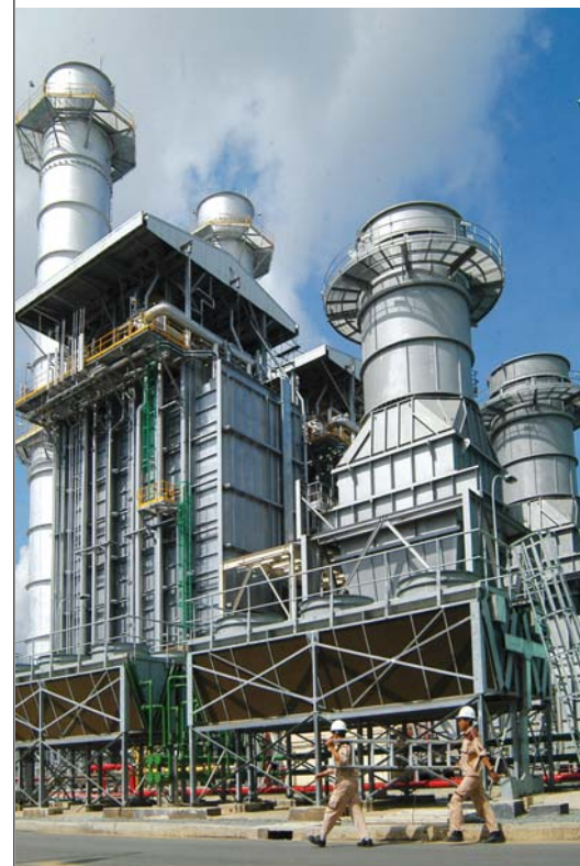
■ Một góc Nhiệt điện Nhơn Trạch
