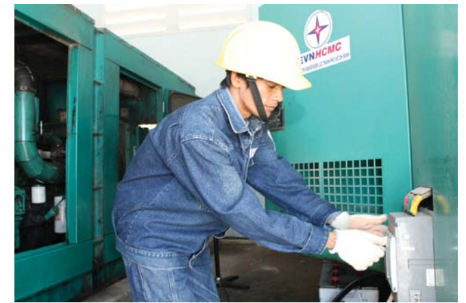
■ Công nhân Tổng Công ty Điện lực TP. Hồ Chí Minh vận hành cấp điện cho các phụ tải trên đảo Thạnh An (huyện Cần Giờ)
